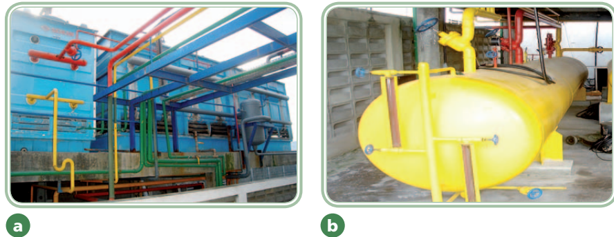
Figura 3.22: (a) Torre de resfriamento de água e (b) cilindro para armazenagem do gás amônia
