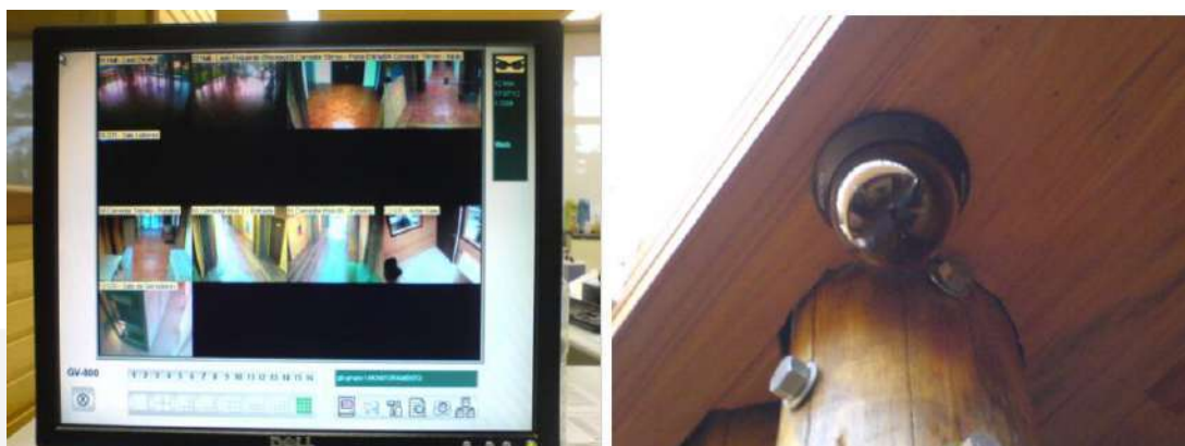
Figura 1 e 2 - Sistema de monitoramento
